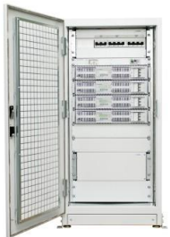
IS3340CM 40 кВА/ 32 кВт
