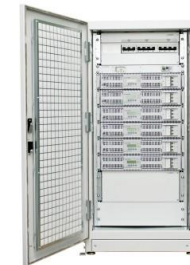
IS3360CM 60 кВА/ 48 кВт
